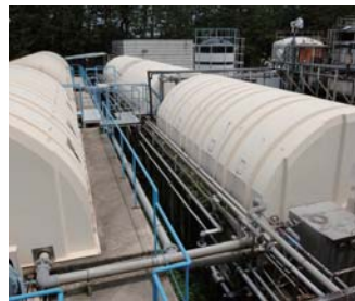
回転円板排水浄化装置
