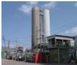
地上型曝気槽と汚泥乾燥設備
