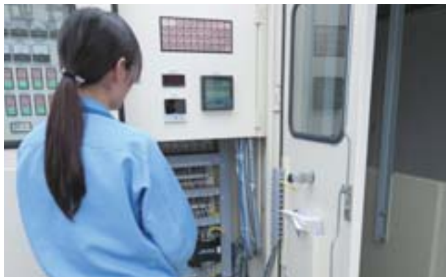
絶縁抵抗測定(大阪技術開発センター)
