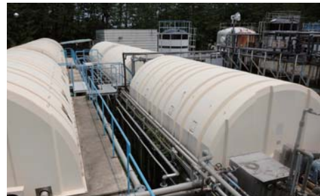
回転円板排水浄化装置
