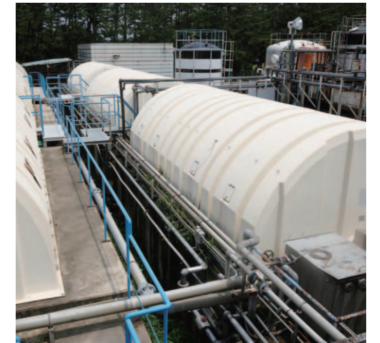
回転円板排水浄化装置
