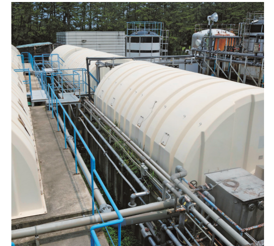
回転円板排水浄化装置
