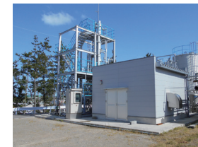
1,4-ジオキサン含有廃水処理設備（福井工場）
